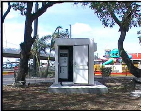
Station « Dillon » Carrefour Dillon, Mise en service le 15/05/2001
